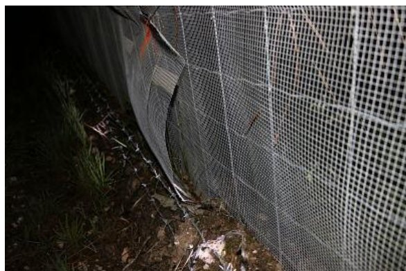
Figure 42 : Problème d'étanchéité du grillage
