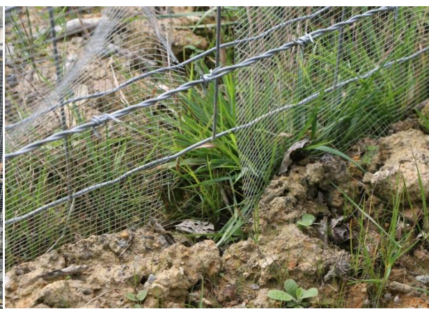
Figure 41 : Problème d'étanchéité du grillage
