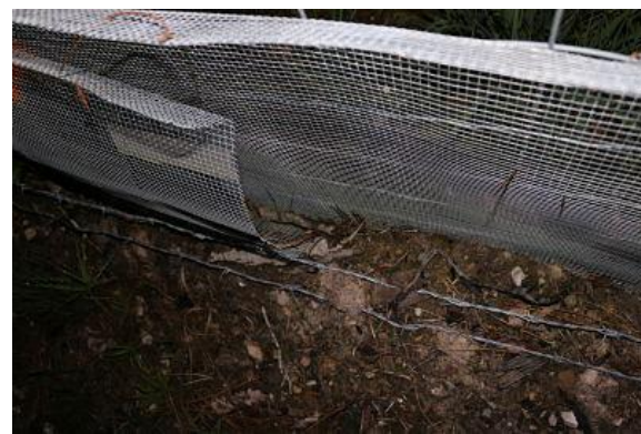
Figure 43 : Problème d'étanchéité du grillage
