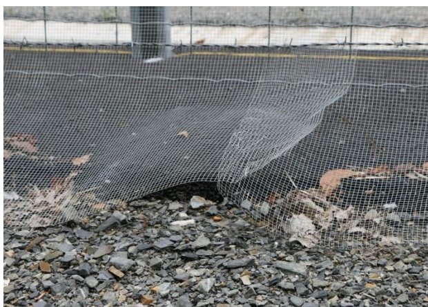
Figure 40 : Problème d'étanchéité du grillage
