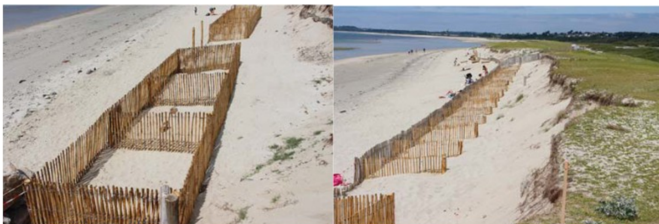
Photographies des AlgoBox® installés sur la plage de Penvins
