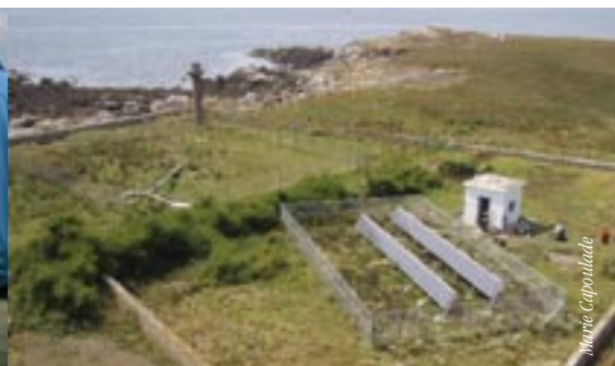
En 2008, la station solaire installée par les Phares et Balises de Concarneau à l'île aux Moutons en remplacement de l'éolienne (que l'on voit couchée à gauche).
