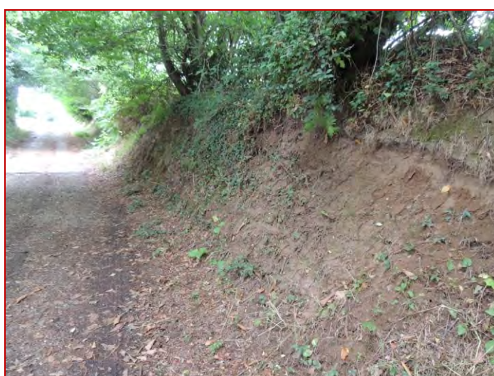
Figure 31. Site « Station épuration 1» le 08/08/2016
