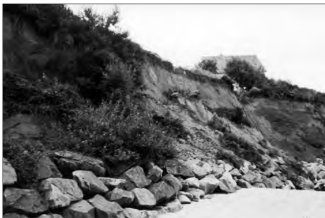
[24] Toul Bili à Carantec. Les enrochements, en vrac, effectués à la base de la falaise, n'empêchent pas les éboulements du limon qui malmènent les blocs rocheux (7/09/2000).
