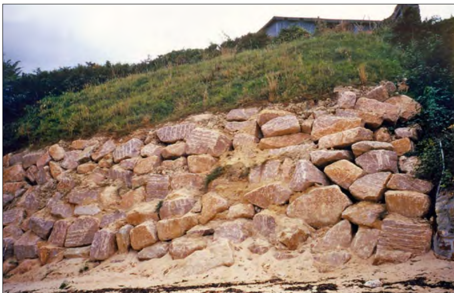
[22] Porz Paol à Carantec. Blocs hétérométriques, à contours irréguliers, en granite de La Clarté, plaqués sur la falaise limoneuse. Des écroulements ont commencé à se produire (7/09/2003).
