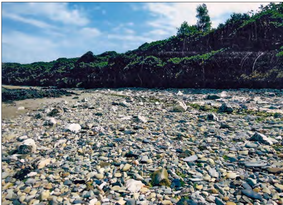
[8] Environs de Kerarmel en Plouézoch (Finistère). L'ancien enrochement en blocs de quartz (de faible dimension, de provenance locale) est à présent dispersé sur l'estran.
