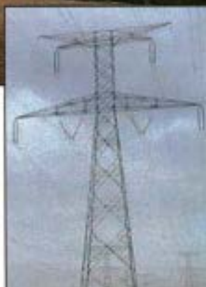
Cliché 3 : ligne THT 400 kW
