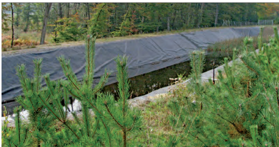
Bassin de décantation de l'autoroute A84
