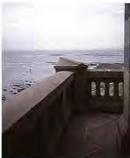
Les oiseaux se blessent ou se tuent en heurtant les saillies supérieures du phare – ici la balustrade sommitale.
