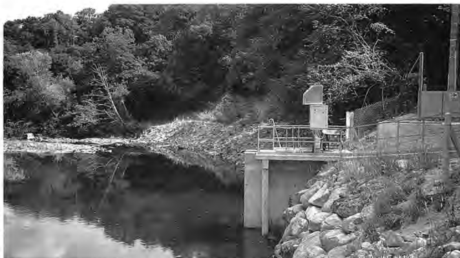
Station de pompage sur le Leguer.
