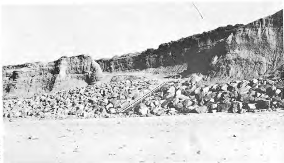
Derrière l'enrochement, la falaise de la Mine d'Or en Pénestin (pointe de l'étain)... La toponymie perpétue le souvenir des anciennes exploitations des sables stannifères.
