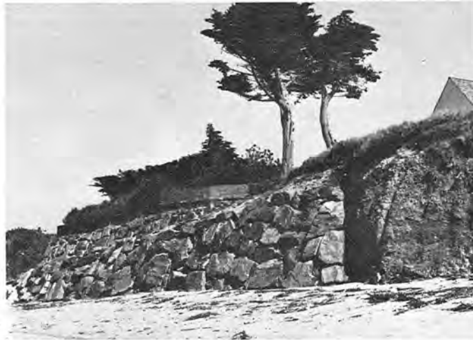
L'esthétique discutable des enrochements plaqués contre la falaise (la Cabonnais, Mesquer).
