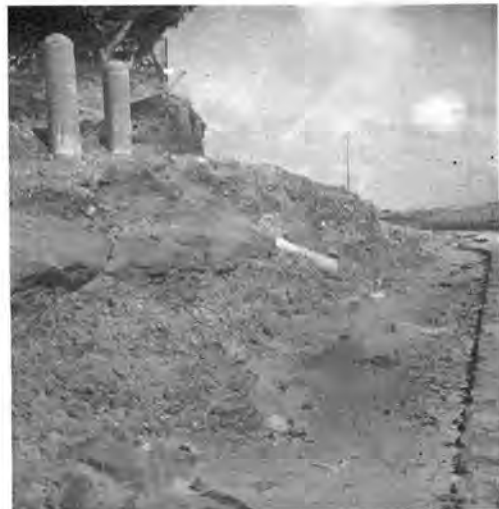
Fig. 5. — Erosion de la falaise meuble à l'arrière du mur ; balise éboulée (fin mai 1973).
