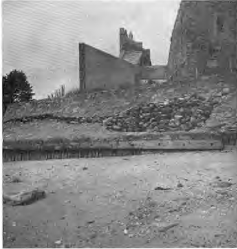
Fig. 4. — L'effondrement du mur à l'Ermitage. Déchaussement des palplanches de la base. Amas de sable à l'amont du coëf cimenté. La brèche a été sommairement bouchée par des moëllons. A gauche de leur amas, l'affaissement du mur courbe est net (fin mai 1973).
