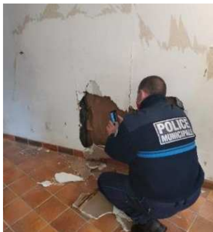
Photo 52 : Constatation du dégât des eaux et de l'insalubrité du local par la police municipale, © RNN Groix, 2021.
