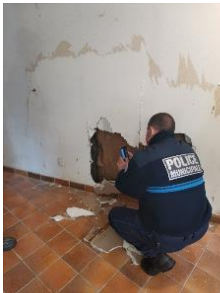
Photo 52 : Constatation du dégât des eaux et de l'insalubrité du local par la police municipale, © RNN François Le Bail, 2021.
